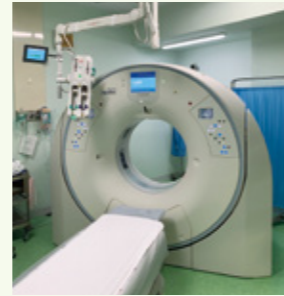
CT 検査室 高精度 CT 装置
