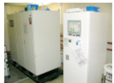
水処理装置 [RO 装置] (左) 透析液供給装置 (右)
