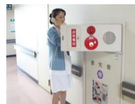
防災センターへの第一報です。
