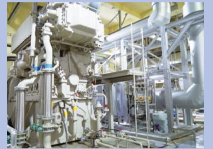
増設された自家発電装置
