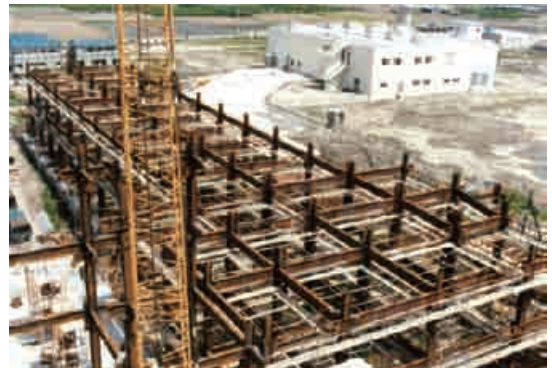
中央機械室（昭和56年）
