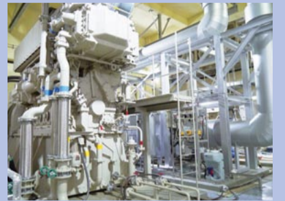
増設された自家発電装置
